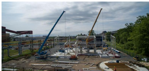
Kogeneracijsko postrojenje BE-TO Sisak
