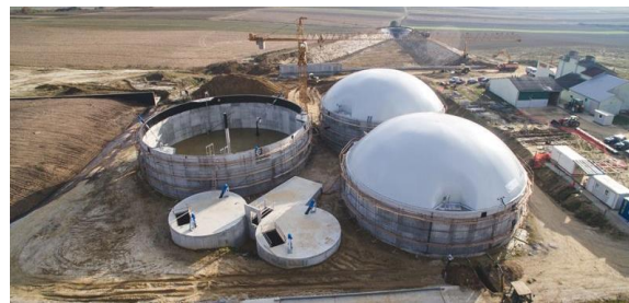
Biogas plant, Gregurovec
